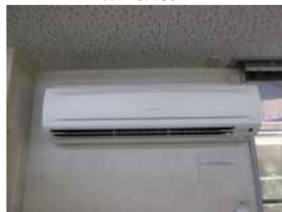
(省エネエアコンに切替)
