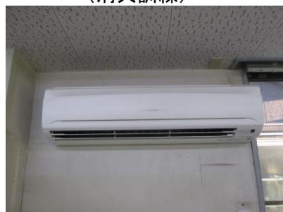
(省エネエアコンに切替)
